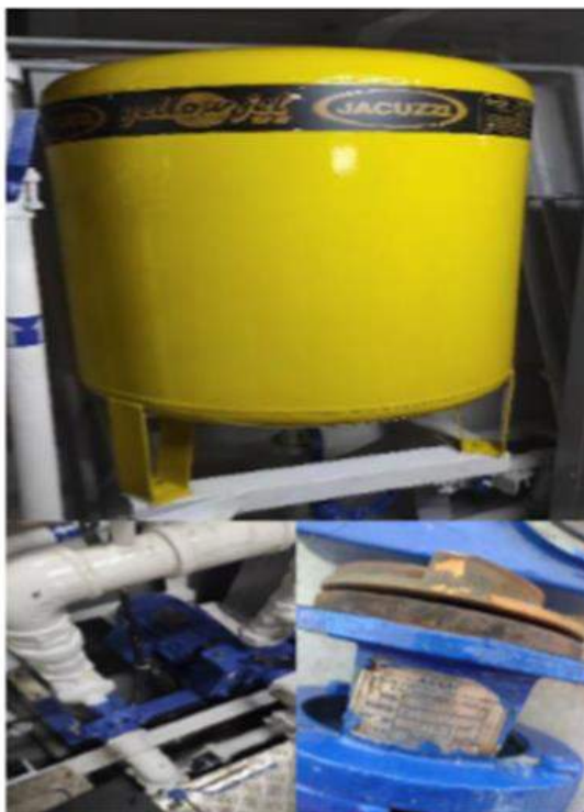
Figura 32 - Imagens da bomba e do hidrofor.
