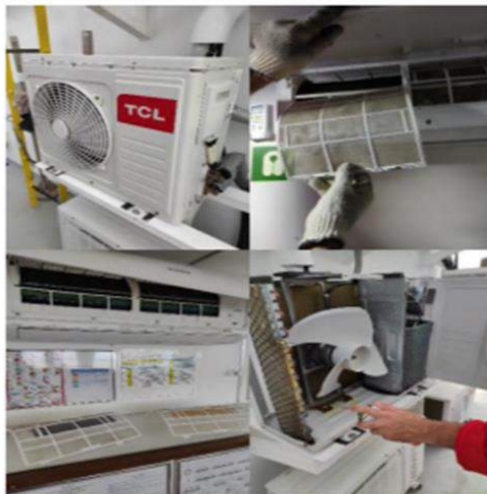
Figura 25 - Equipamentos de ar-condicionado em manutenção.
