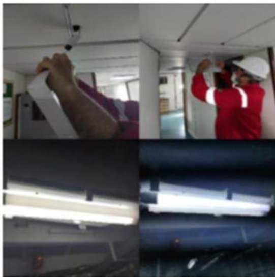
Figura 34 - Paineis sobrepostos e lâmpada tubular substituídos.
