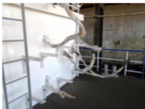
Foto nº 29 – Suportes e esperas para os splits
