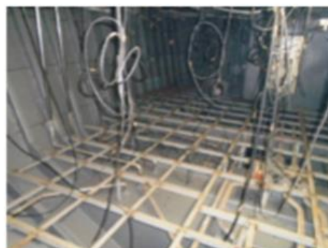
Foto nº 49 – Cabeamento e tubos diversos
