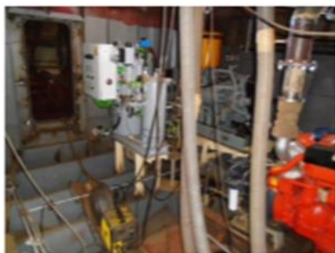
Foto nº 56 – Separador água / óleo
