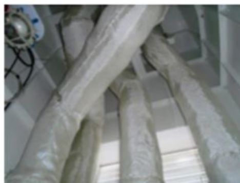
Foto nº 20 – Redes de descarga de gases
