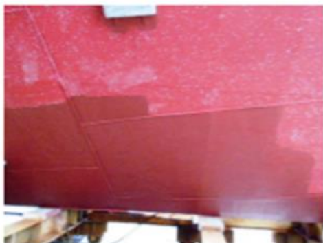
Foto nº 8 – Chapeamento parcialmente tratado
