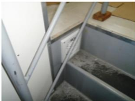
Foto nº 7 – Exaustor do espaço sob passadiço
