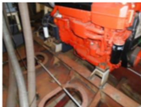
Foto nº 55 – Motor propulsor de bombordo
