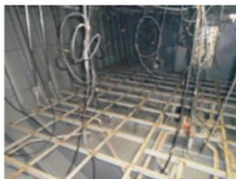
Foto nº 49 – Cabeamento e tubos diversos
