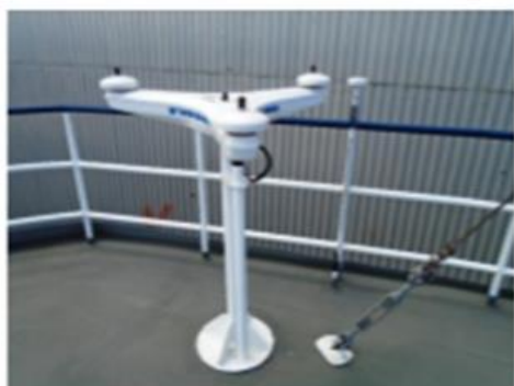
Foto nº 9 – Antenas do giro satélite e GPS
