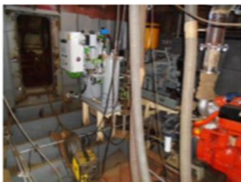
Foto nº 56 – Separador água / óleo
