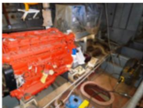
Foto nº 54 – Motor propulsor de boreste
