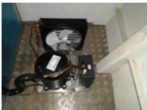
Foto nº 18 – Compressor da camarita
