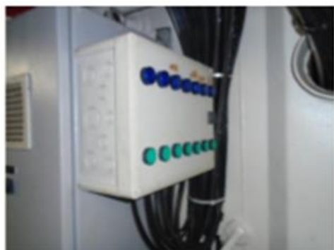
Foto nº 15 – Painel de nível alto de tanques
