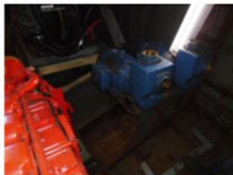
Foto nº 59 – Bombas de serviços gerais
