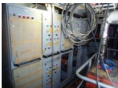
Foto nº 26 – Quadro elétrico principal
