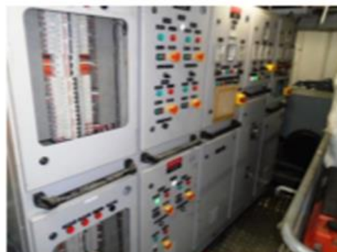
Foto nº 20 – Quadro elétrico principal
