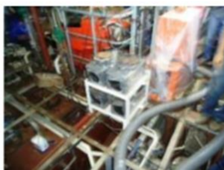
Foto nº 27 – Baterias e unidade hidráulica
