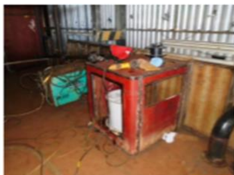
Foto nº 41 – Caixa de ventilação
