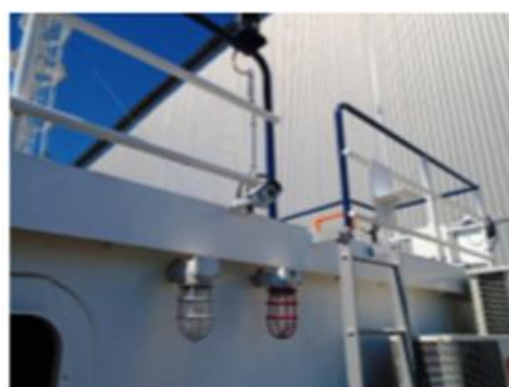
Foto nº 27 – Câmera de monitoramento
