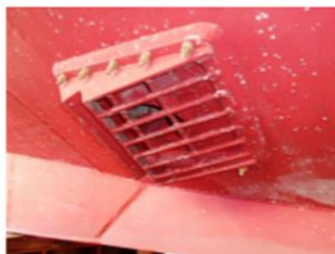
Foto nº 11 – Marcas de incrustação
