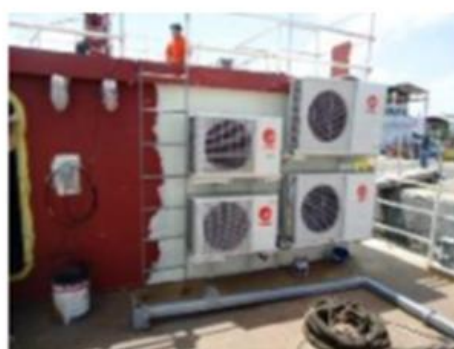
Foto nº 15 – Unidades Condensadoras na rê da casaria
