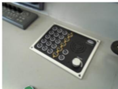
Foto nº 18 – Painel de intercomunicação
