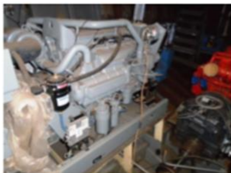
Foto nº 58 – Grupo gerador de bombordo
