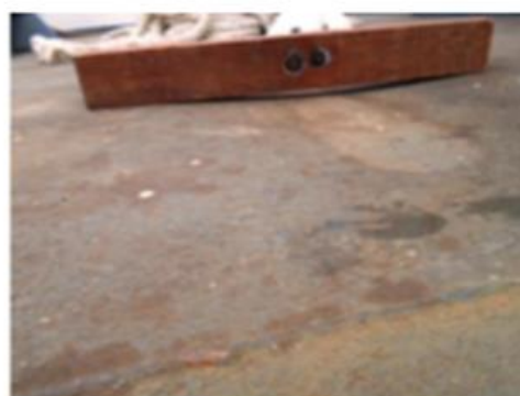
Foto nº 3 – Deformação no convés
