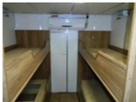
Foto nº 16 – Ar condicionado em operação
