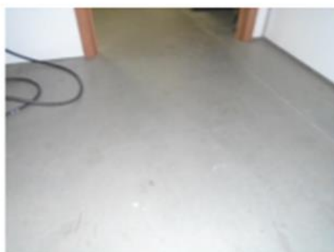
Foto nº 27 – Deformação no piso
