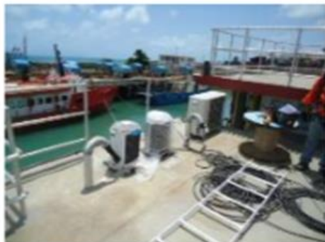
Foto nº 16 – Unidades Condensadoras no teto da casaria
