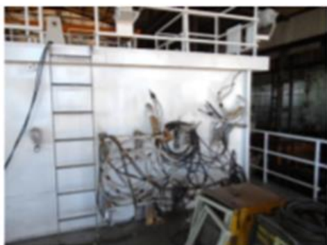
Foto nº 48 – Tubulações do ar condicionado
