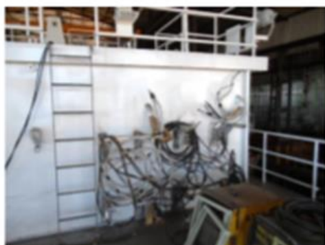
Foto nº 48 – Tubulações do ar condicionado
