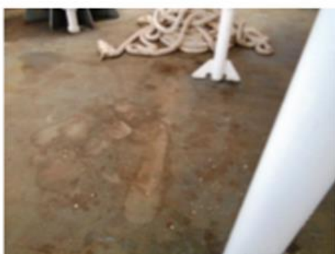
Foto nº 2 – Deformação no convés
