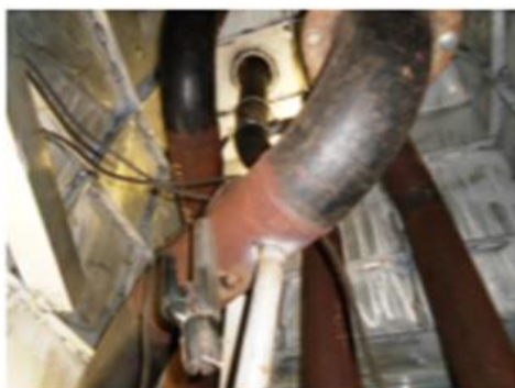
Foto nº 23 – Dutos de descarga de gases
