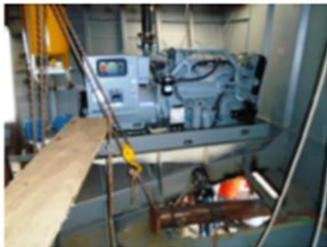
Foto nº 28 – Grupo gerador a bordo do 655
