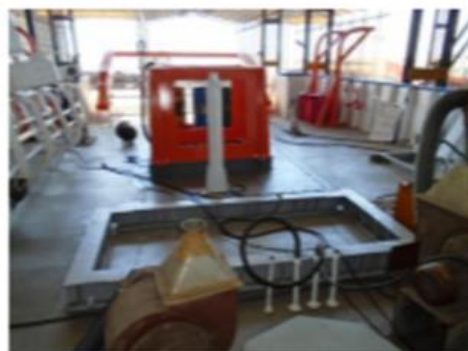
Foto nº 14 – Bases dos diversos guinchos
