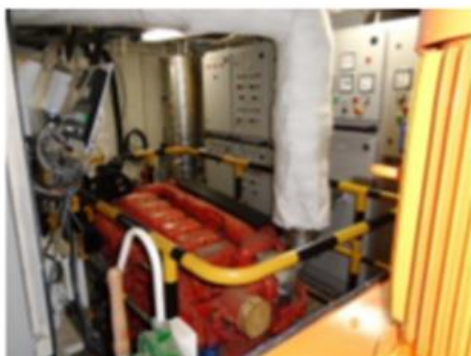
Foto nº 19 – MCP de BE e quadro elétrico
