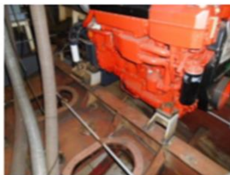
Foto nº 55 – Motor propulsor de bombordo
