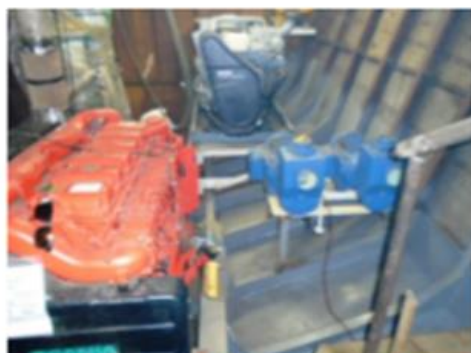
Foto nº 37 – MCP de BB e bombas
