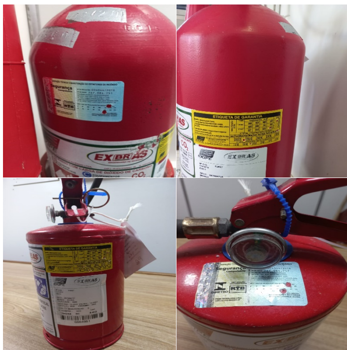
Figura 41. Extintores etiquetados após a inspeção.
