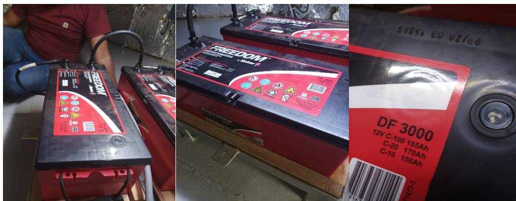
Figura 14. Inspeção nos quadros de baterias a bordo.
