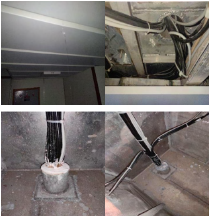
Figura 34. Infiltração, entrada do cabeamento e massa veda-calha aplicada no local.
