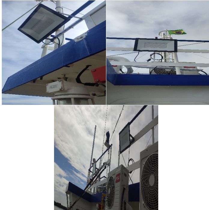
Figura 36. Painel sobrepor e lâmpada tubular substituídos.
