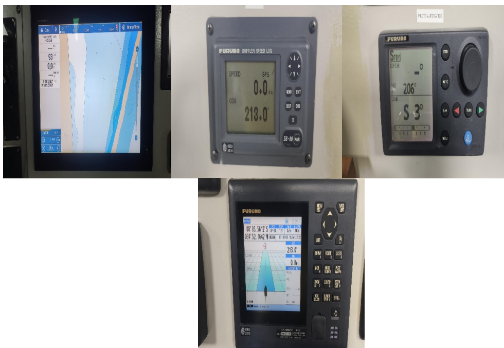
Figura 15. Testes nos equipamentos do passadiço.
