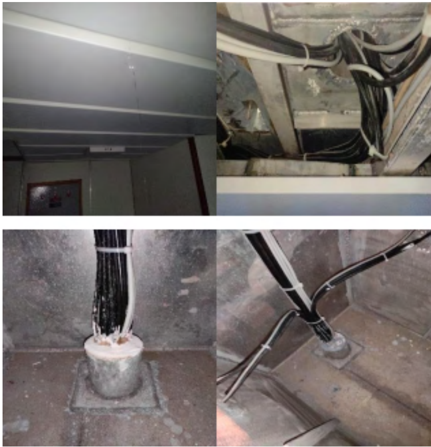
Figura 33 - Infiltração, entrada do cabeamento e massa veda-calha aplicada no local.
