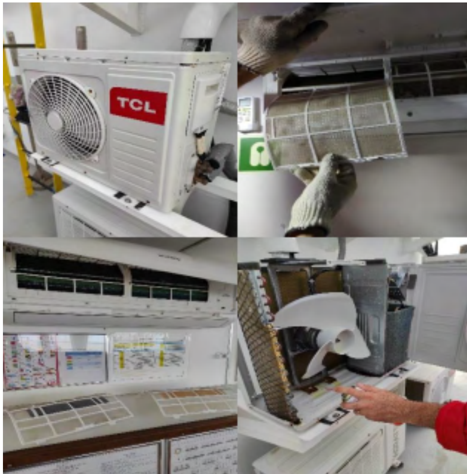
Figura 25 - Equipamentos de ar-condicionado em manutenção.
