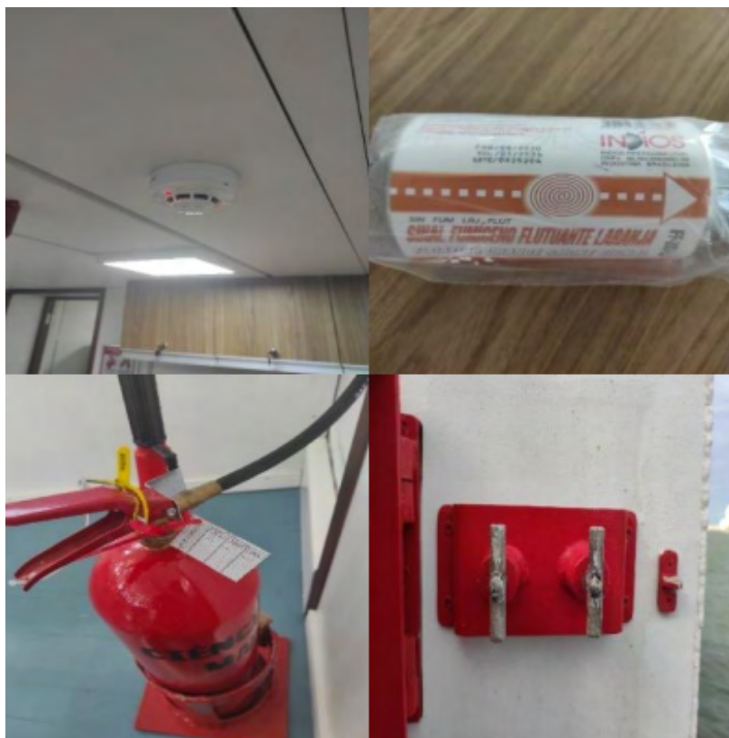
Figura 43 - Detector de fumaça acionado, fumígeno, extintor de CO2 e parada de emergência.
