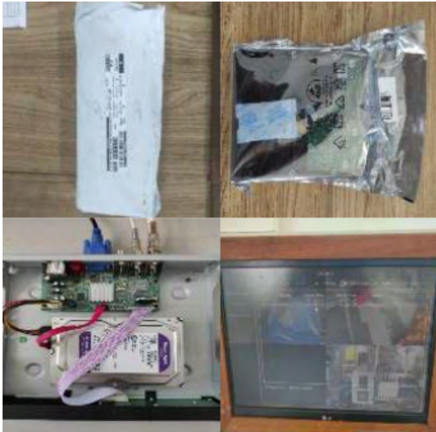
Figura 49 - Disco rígido e instalação no DVR.
