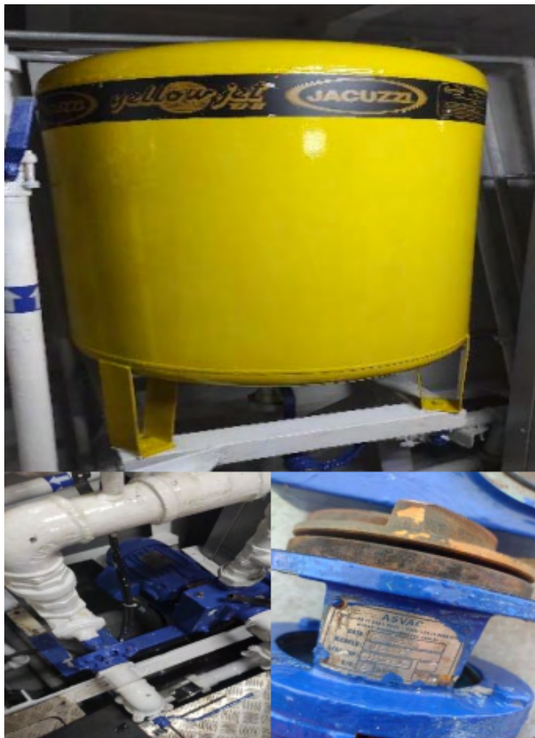
Figura 32 - Imagens da bomba e do hidrofor.
