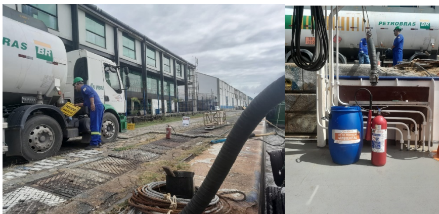
Figura 21. Preparação e recebimento de óleo combustível para os motores.
