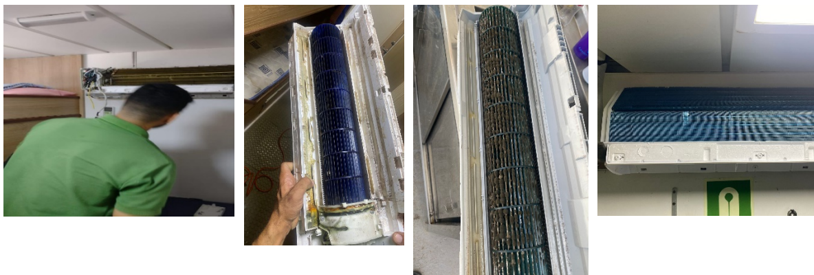
Figura 13 - Fotos do serviço de manutenção e reparo dos aparelhos de ar condicionado
