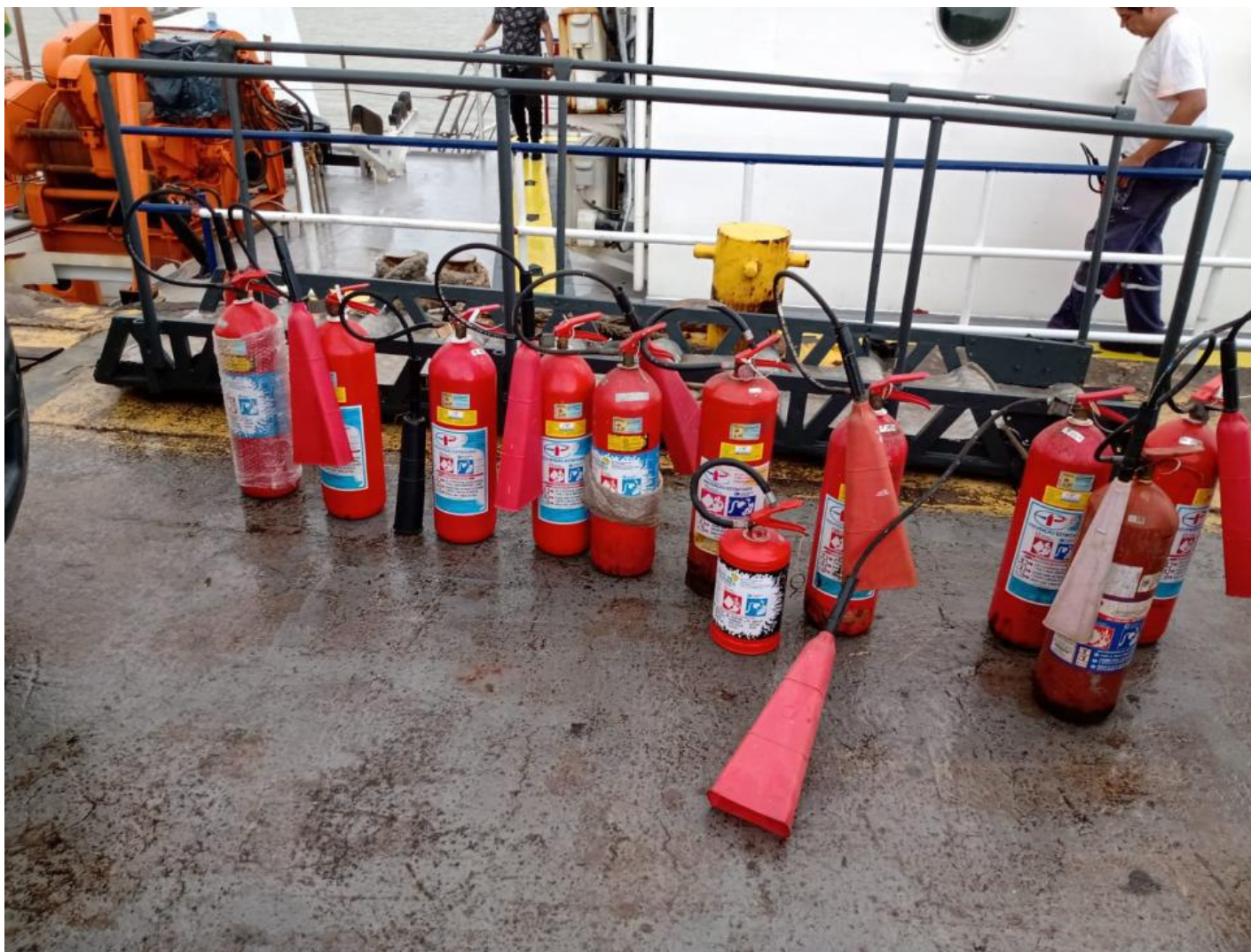
Figura 11 - Revisão dos extintores de incêndio, em cumprimento às Normas da Autoridade Marítima e ABNT. Julho 2022.
