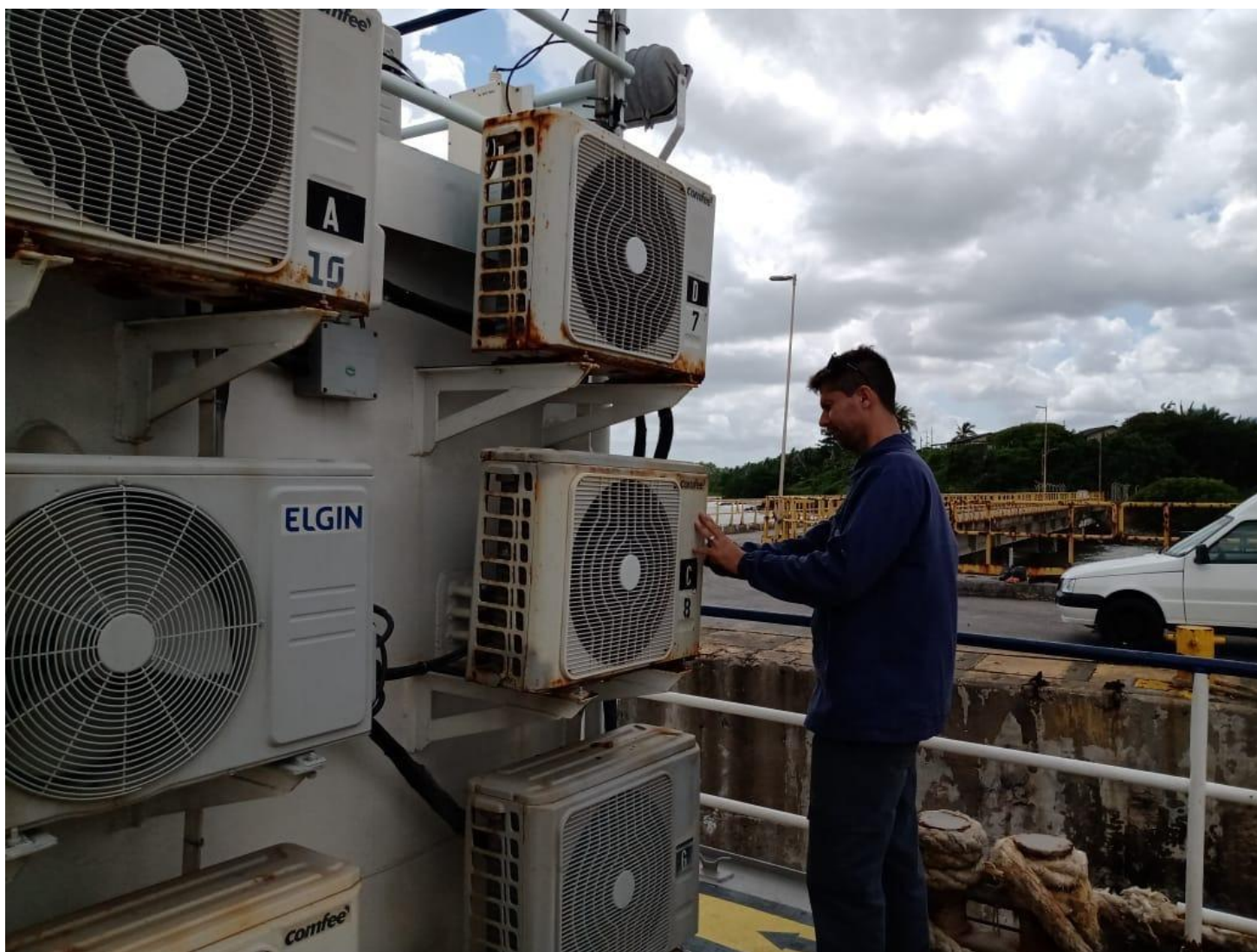
Figura 15 – Manutenção de ar condicionado. Os aparelhos são trocados quando a corrosão inviabiliza o uso. Setembro/2022.
