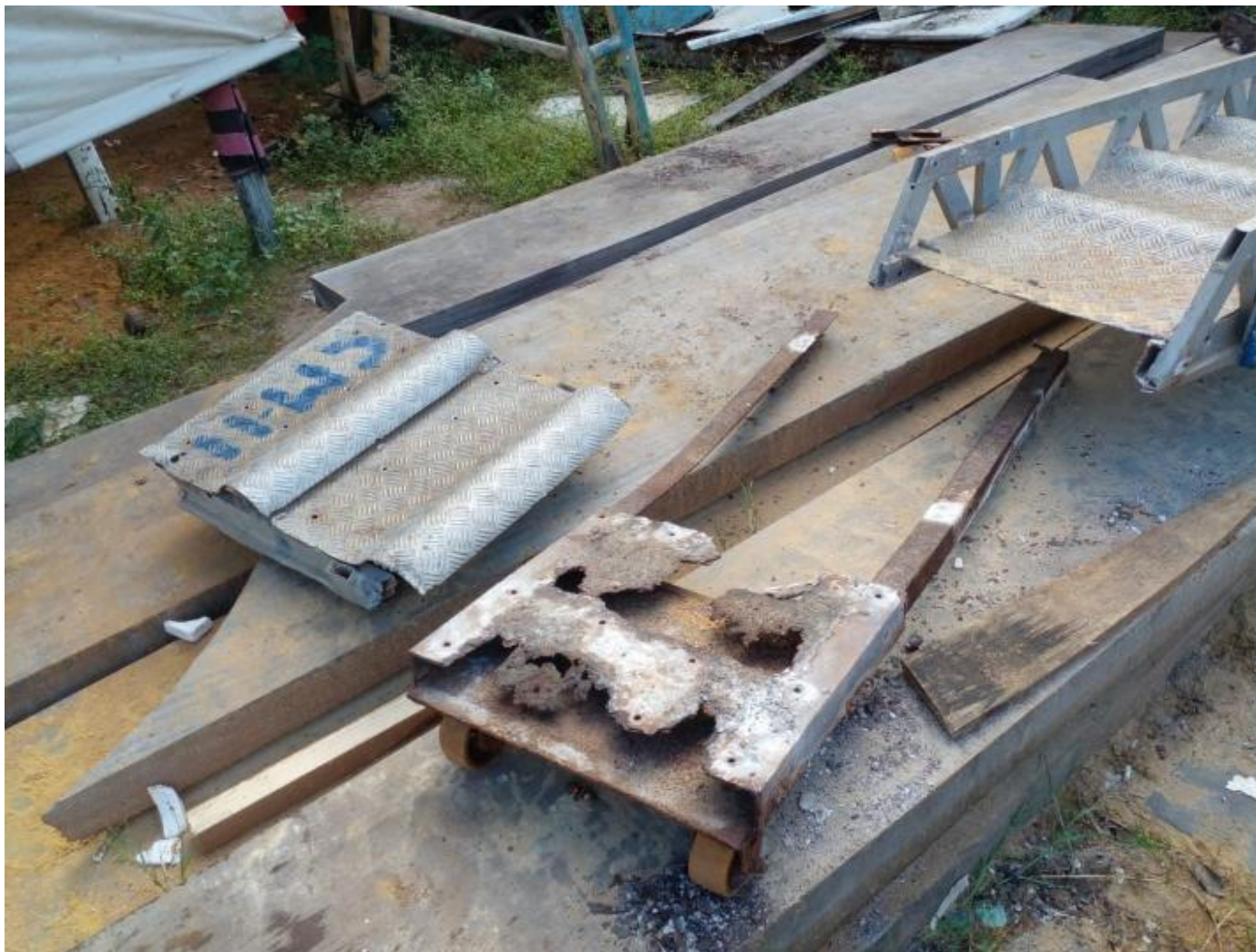
Figura 10 – Manutenção da escada de acesso ao navio. Estava apresentando fissuras graves. Junho de 2022.
