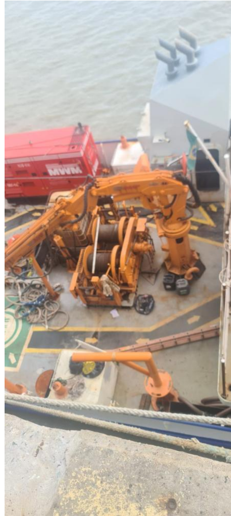
Figura 8 - Desmontagem da linha hidráulica de acionamento da lança telescópica, para retirada de vazamento. Maio/2022
