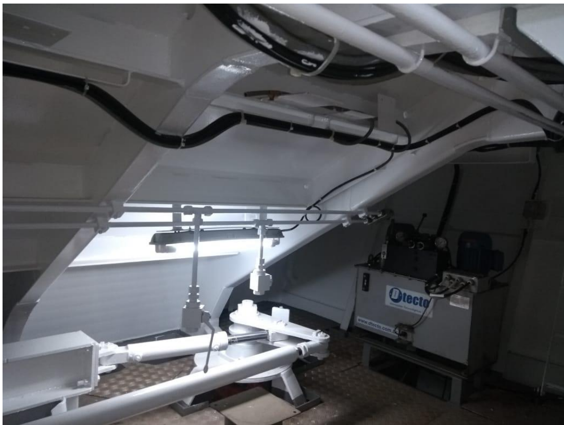
Foto 22: Equipamento do Sistema de governo.
