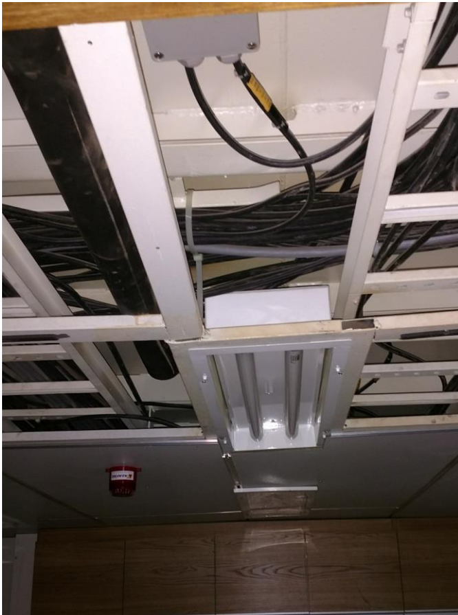
Foto 2 - Forro laboratório aberto para cabeação
