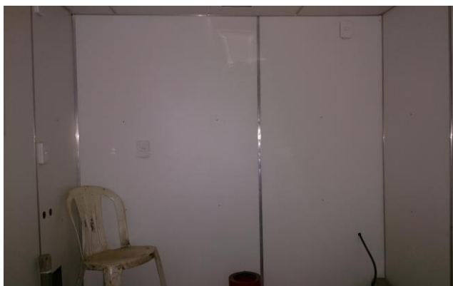
Foto 15 - cozinha sem bancadas, armários, fogão.
