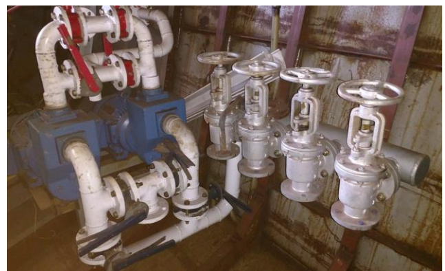
Foto 22 – bombas e piano de válvulas
