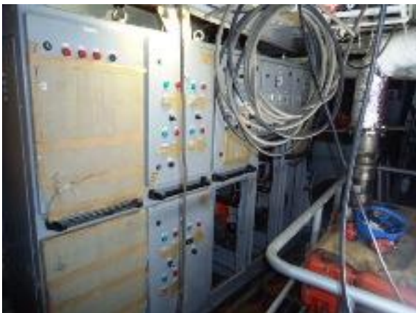
Foto nº 26 – Quadro elétrico principal
