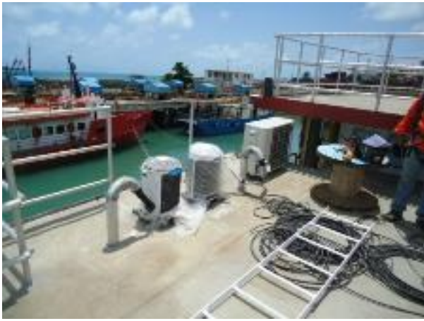
Foto nº 16 – Unidades Condensadoras no teto da casaria
