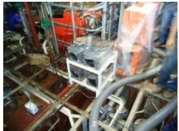
Foto nº 27 – Baterias e unidade hidráulica
