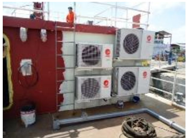
Foto nº 15 – Unidades Condensadoras na ré da casaria
