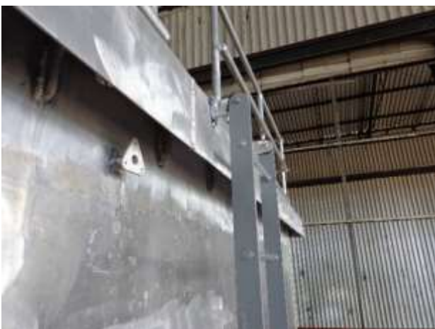
Foto nº 26 – Escada para teto da cabine
