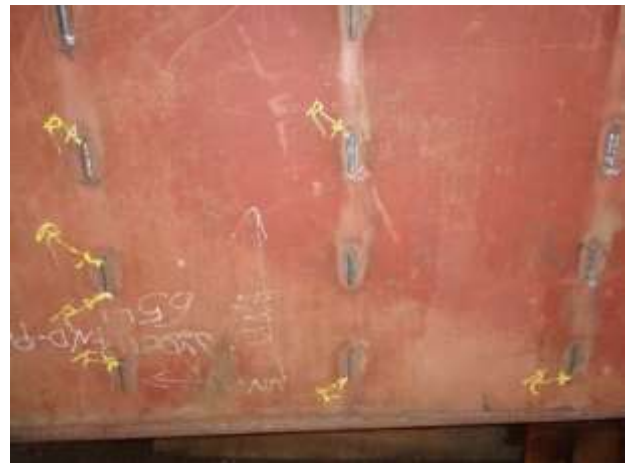
Foto nº 3 – Pontos de vazamento no skag
