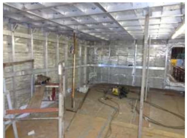
Foto nº 57 – Interior da cabine do casco 656
