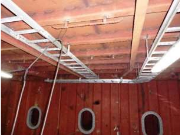
Foto nº 34 – Calhas na praça de maquinas
