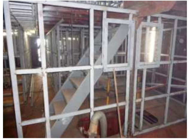
Foto nº 11 – Bases para quadros elétricos
