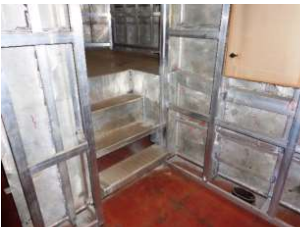
Foto nº 14 – Acesso ao passadiço corrigido
