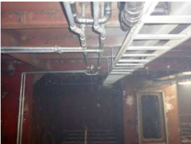
Foto nº 12 – Rede hidráulica e calhas
