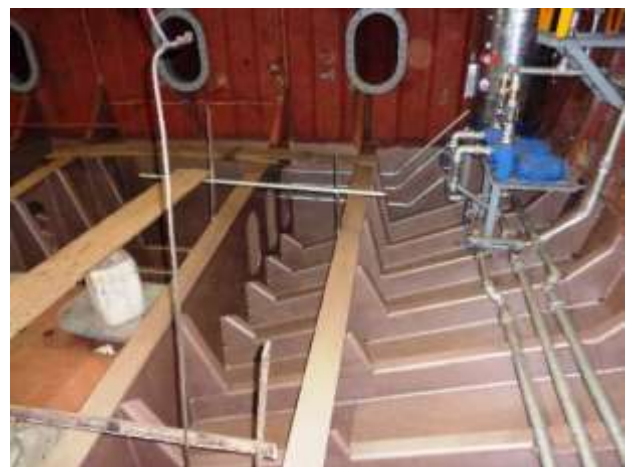
Foto nº 33 – P.M. parcialmente pintada
