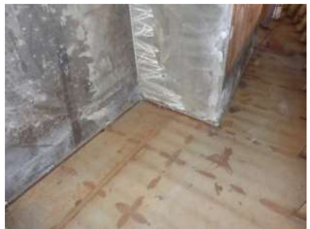
Foto nº 45 – Cabine sobre barra clad
