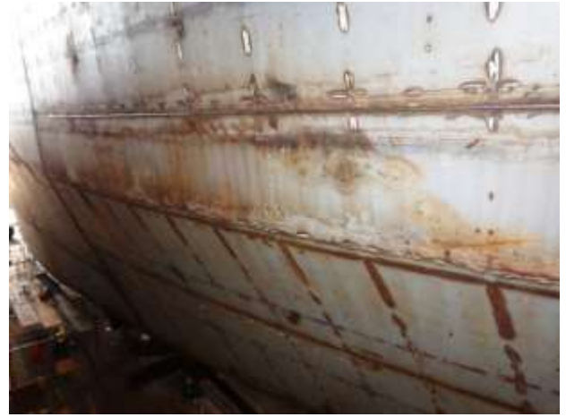
Foto nº 41 – Falta solda externa do castelo
