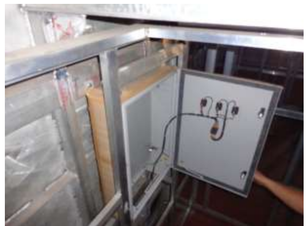
Foto nº 15 – Quadro elétrico do passadiço
