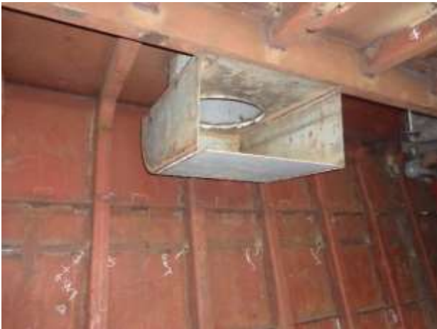
Foto nº 24 – Dutos de ventilação na P.M.
