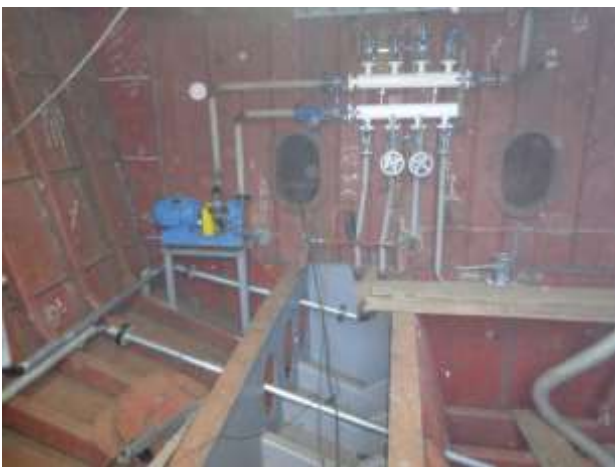
Foto nº 14 – Bomba de transferência de O.D.
