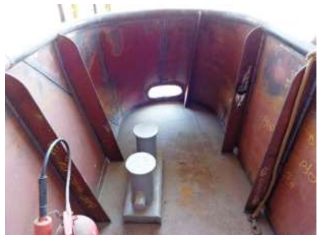
Foto nº 9 – Buzina em posição inadequada
