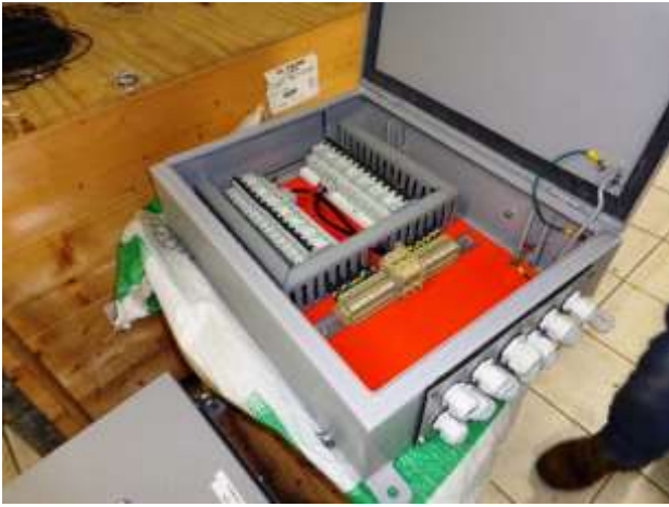
Foto nº 46 – Painel elétrico para o casco 653
