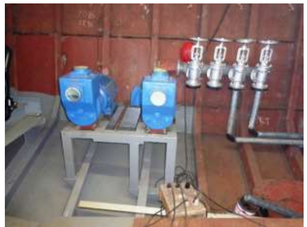
Foto nº 13 – Bombas de incêndio e esgoto
