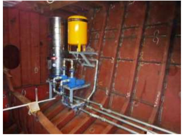
Foto nº 23 – Praça de máquinas do 654
