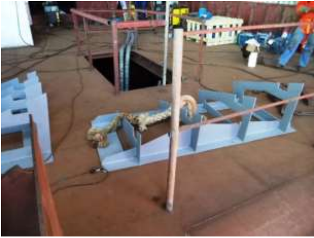
Foto nº 7 – Bases dos geradores
