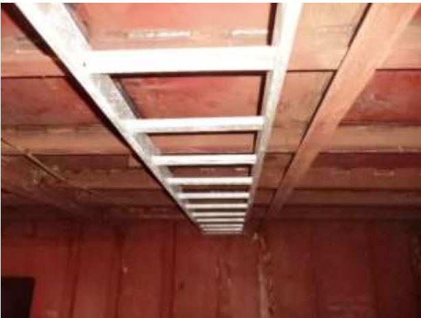
Foto nº 5 – Caminho mecânico para cabos
