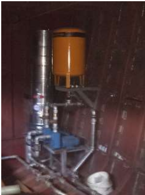
Foto nº 9 – Equipamentos na Praça de Maquinas
