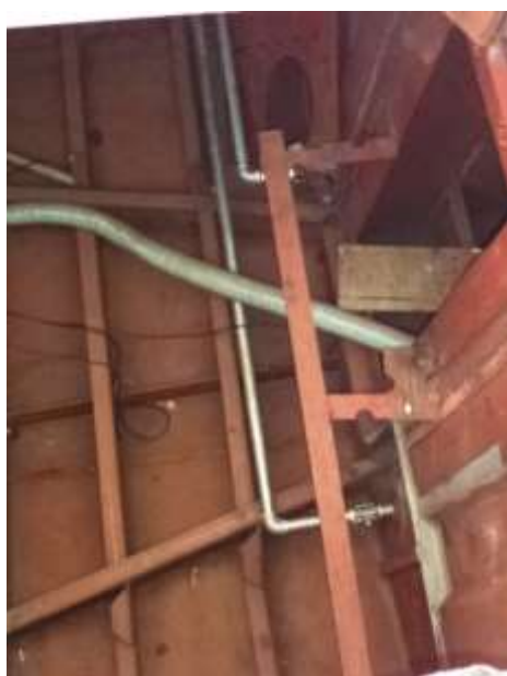
Foto nº 11 – Tubulações na Praça de Maquinas
