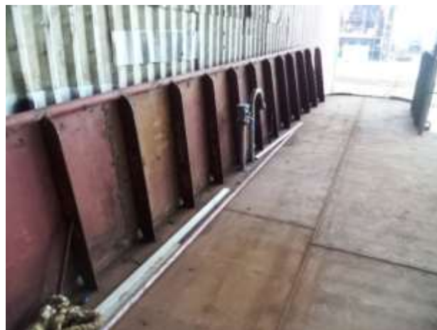
Foto nº 10– Suspiro e tubo de enchimento
