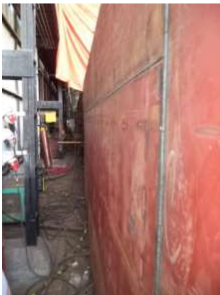
Foto nº 17 – Soldas no castelo casco 654
