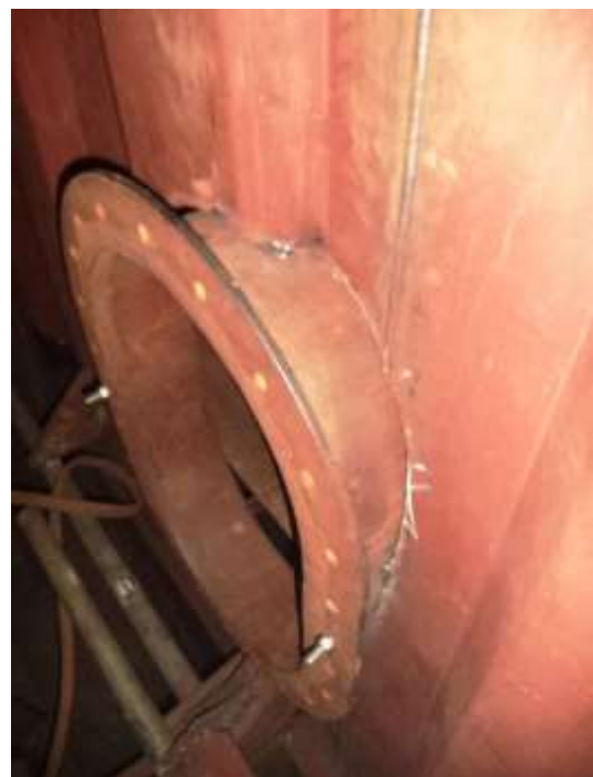
Foto nº 10– Porta de visita de tanque
