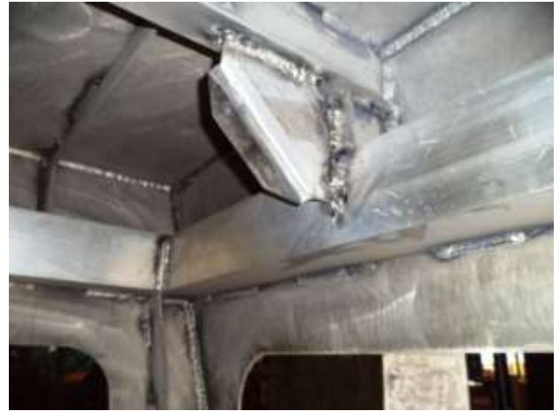
Foto nº 24 – Defeito de soldagem
