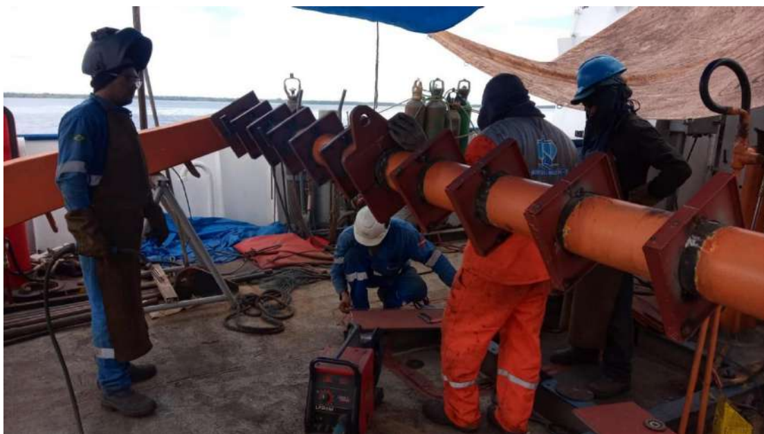
Figura 4a) Suportes de aço sendo montados na viga do A-frame para aumentar a sua capacidade de carga, evitando uma flexão indesejada.
