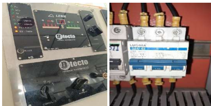
Figura 26. Disjuntor substituto e chave seletora do modo de leme.
