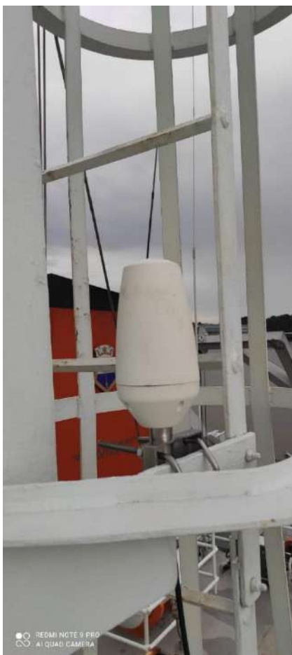
Figura 9b) Antena do Iridium que permite a comunicação de dentro do passadiço.
