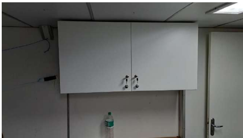
Figura 5b) – Armários instalados no Laboratório Seco do NEP CM II.
