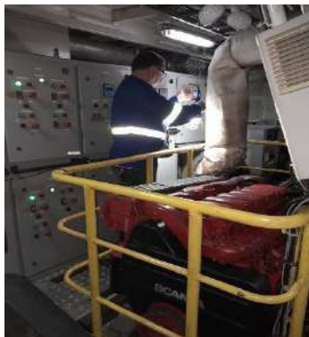
Figura 24. Serviço de análise de tensão elétrica recebida e gerada na embarcação.
